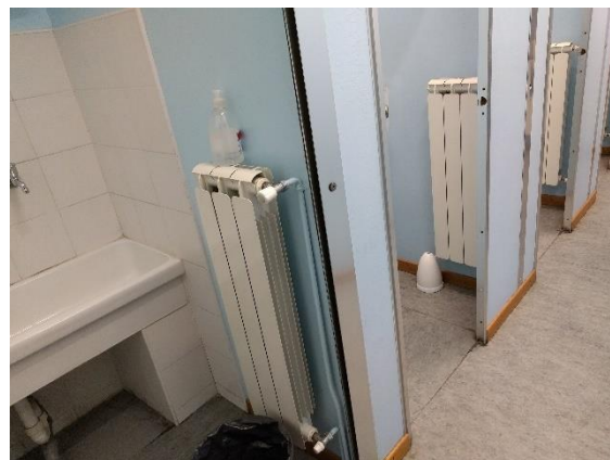
Figura 4.6 – Particolare dei radiatori
